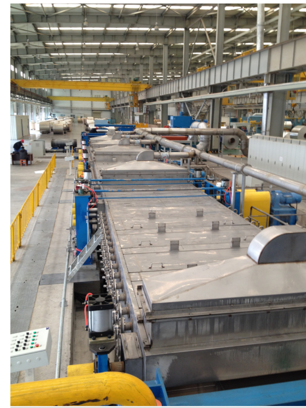
铝板清洗机组自动化生产线
