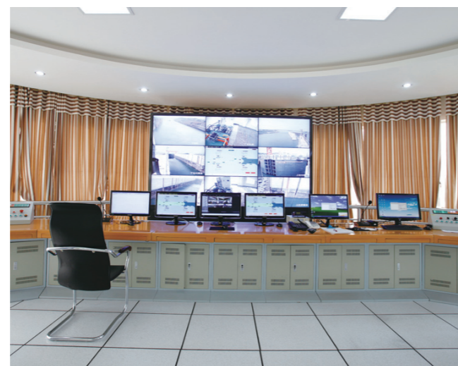
广西桂平二线船闸自动化控制室
